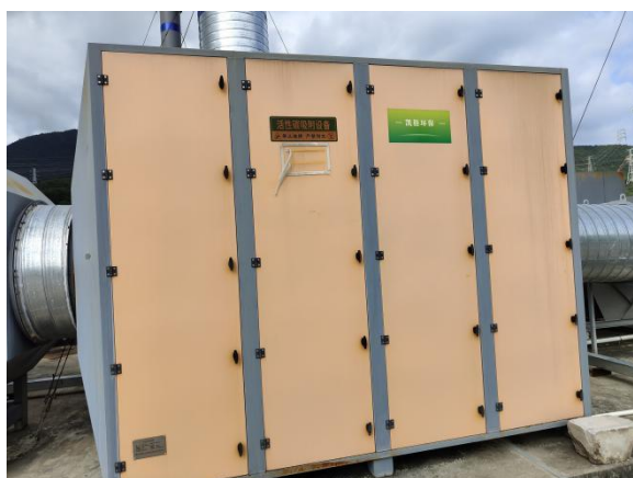
轧制废气处理设施：静电油烟净化器+活性炭吸附
