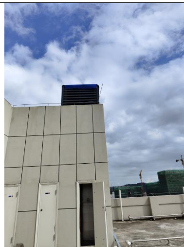
食堂油烟排放口 DA008
