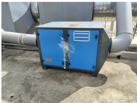
废水处理站臭气处理设施：紫外+活性炭一体机
