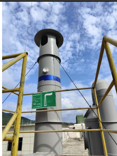
酸洗废气排放口 DA001
