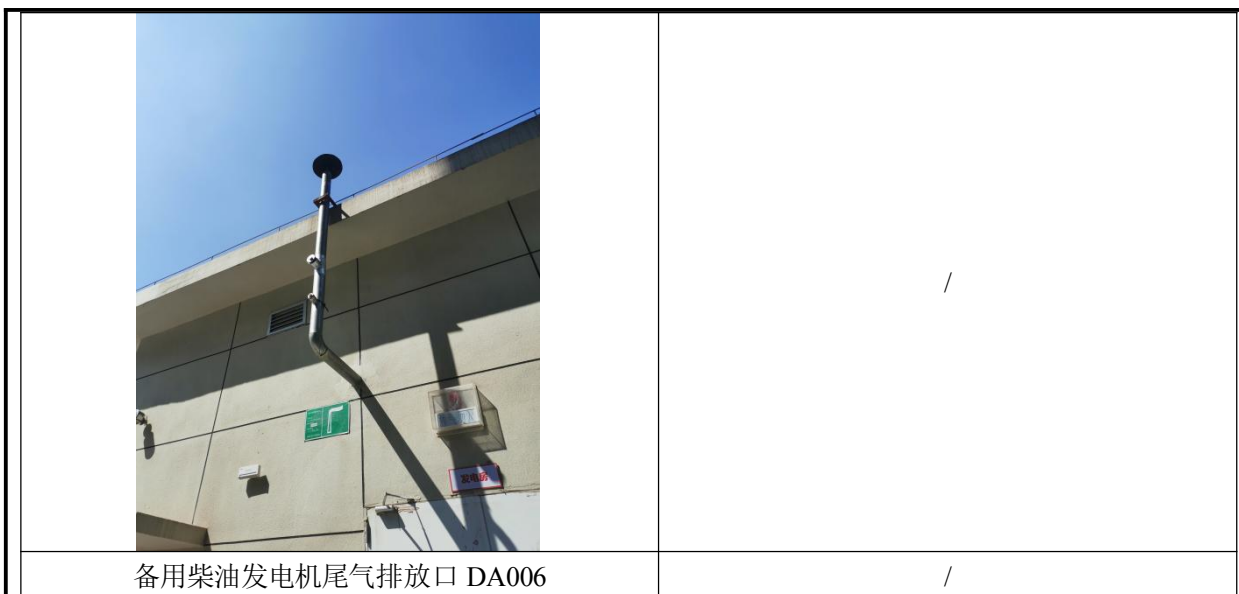
图 3-3 废气收集设施、排放口现状图片
