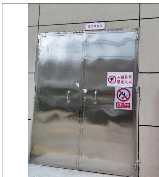
危险废物暂存间
