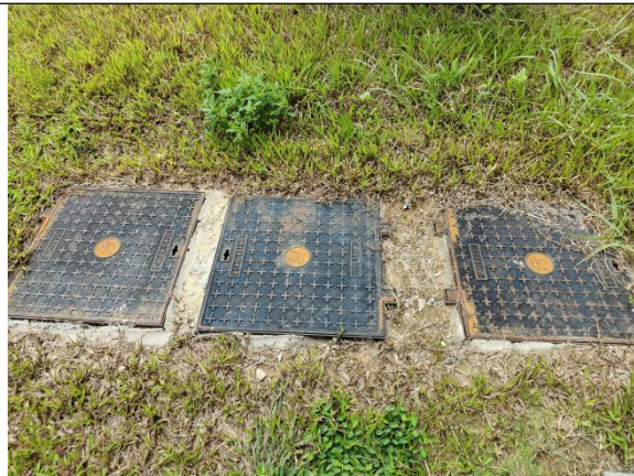
食堂隔油隔渣池
