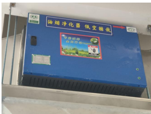
食堂油烟处理设施：静电油烟净化器
