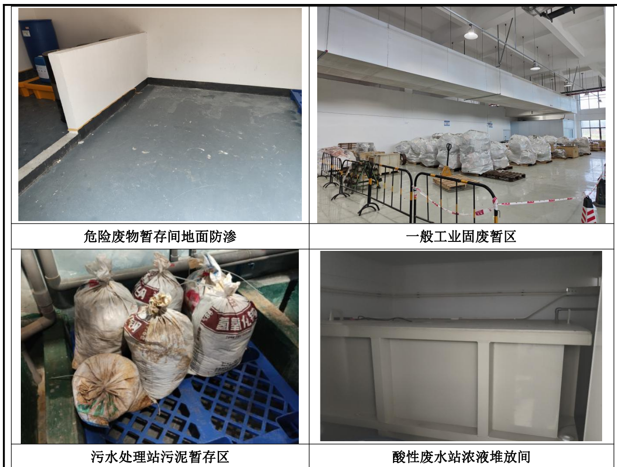
图 3-5 项目危险废物暂存间现状图片
