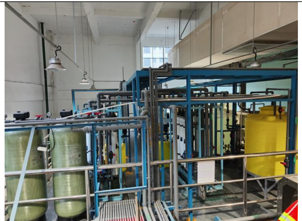
酸洗废水处理站
