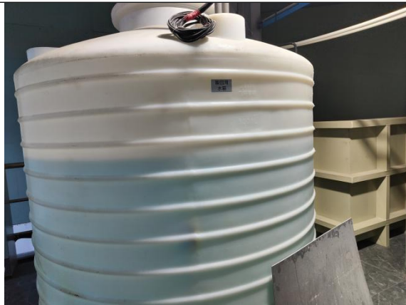
酸洗废水处理站回用水箱
